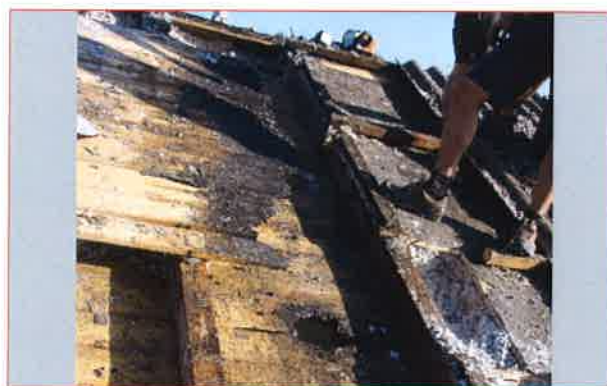
Dachstuhlbrand in Straßwalchen Brandursache: Heißenarbeiten (Flämmen)
