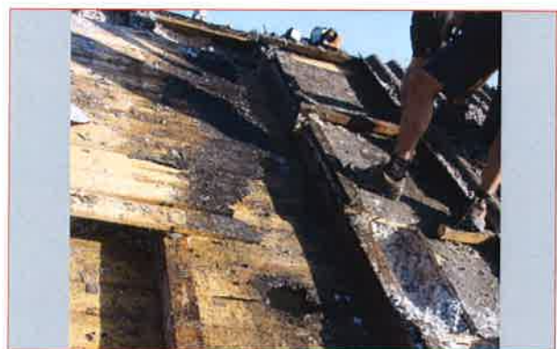
Dachstuhlbrand in Straßwalchen Brandursache: Heißenarbeiten (Flämmen)
