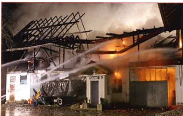
Großbrand in einem Wirtschaftsgebäude Brandursache: Defekt Elektroleitung Heuboden
