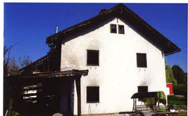
Großbrand in einem Einfamilienwohnhaus Brandursache: Funkenflug aus dem Heizkessel
