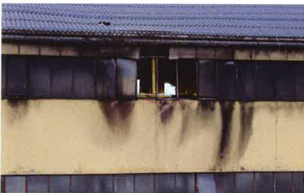
Großbrand in einer Spedition Brandursache: elektr. Defekt der Beleuchtung
