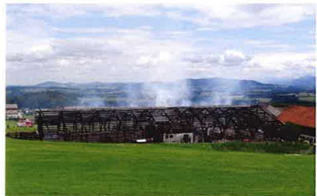
Großbrand in einem landw. Wirtschaftsgebäude Brandursache: techn. Defekt, Akkumulator
