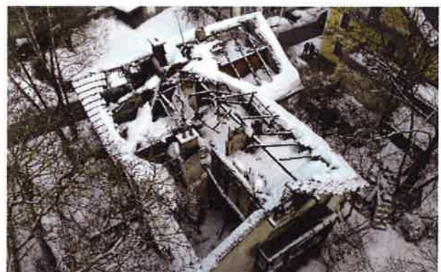
Brand eines Wohnobjektes Brandursache: elektrischer Defekt
